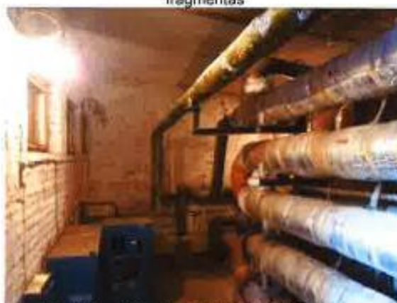
Boilerinės 1H1p (u.n. 8198-5010-1013) vidaus fragmentas
