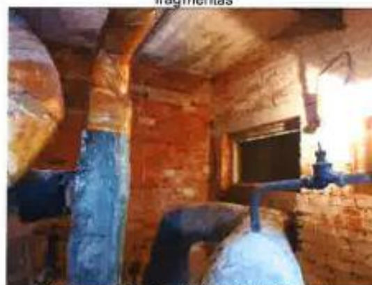
Boilerinės 1H1p (u.n. 8198-5010-1013) vidaus fragmentas
