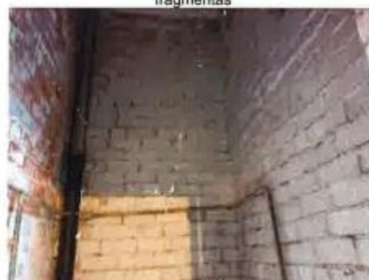
Boilerinės 1H1p (u.n. 8198-5010-1013) vidaus fragmentas
