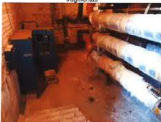
Boilerinės 1H1p (u.n. 8198-5010-1013) vidaus fragmentas
