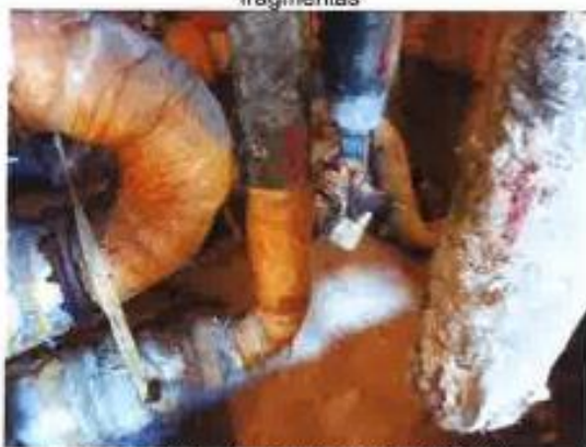
Boilerinės 1H1p (u.n. 8198-5010-1013) vidaus fragmentas
